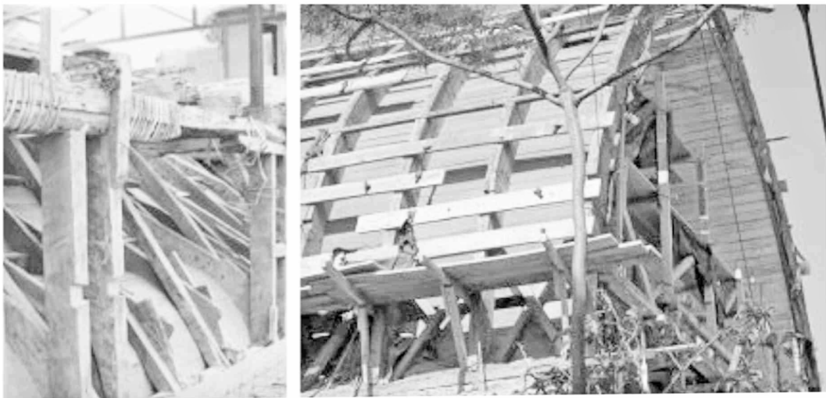
Figura 4: a) Características constructivas de una bóveda encamionada de sistema en viga. b) Bóveda encamionada de sistema en arco.
