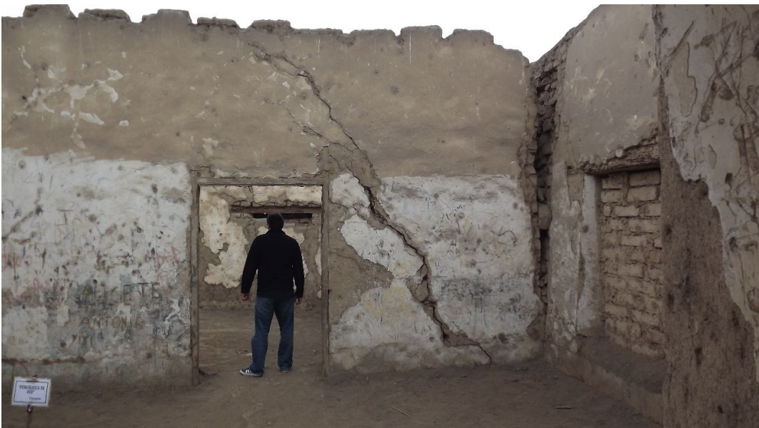
Vista del estado de una de las paredes interiores y el encuentro con uno de los muros exteriores, los que se ha separado. El que está en frente, por asentamiento, lo que está evidenciado por la forma de la grieta. La pared del lado derecho ha perdido el plomo hacia afuera. Foto del autor. 2012
