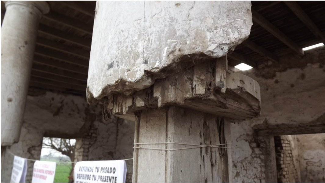
Detalle del estado de las columnas de la loggia de la fachada principal y de la técnica de construcción de las mismas. Foto del autor. 2012
