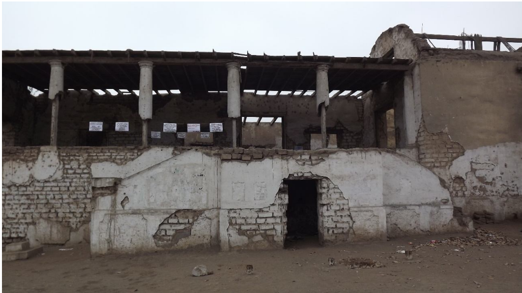
Vista frontal de la fachada. Se aprecia el alto nivel de deterioro del inmueble y, afortunadamente, la técnica constructiva que permitirá su rescate (reconstrucción). Foto del autor 2012
