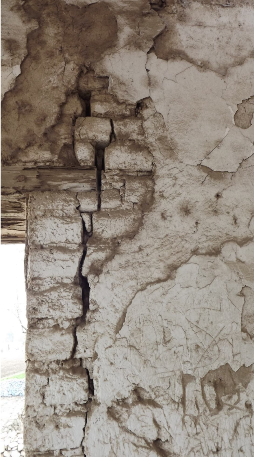
Detalle de una falla por un mal sistema constructivo, el escaso empotramiento del dintel de madera en el muro, lo que ha ocasionado la falla de éste por asentamiento, lo que se puede notar en el desnivel de los adobes. Foto del autor, 2012
